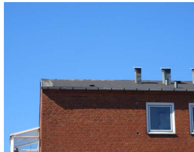
Zinkinddækninger ved gavltrekanter sidder ikke længere tæt.
