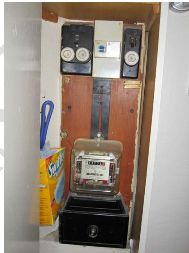
Der findes fortsat en del ældre el-tavler i ejendommen
