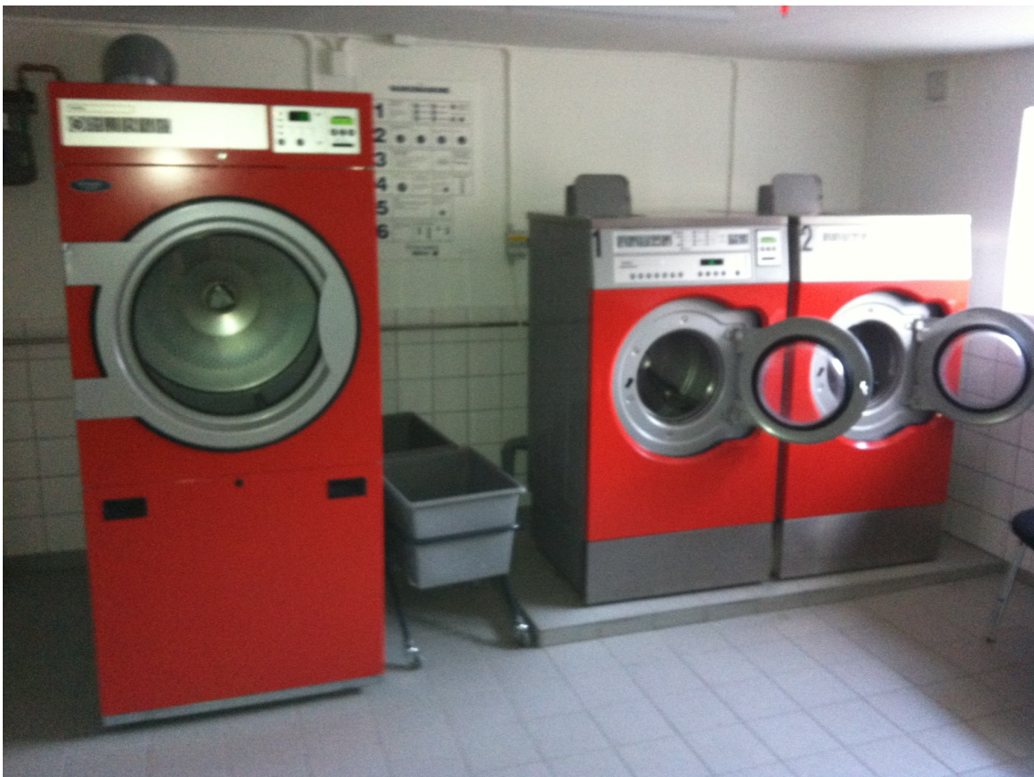
VASKEMASKINER OG TØRRETRUMBLER ER OPSTILLET
